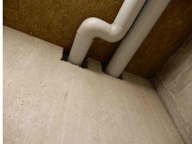
Absence de recouplement au feu
