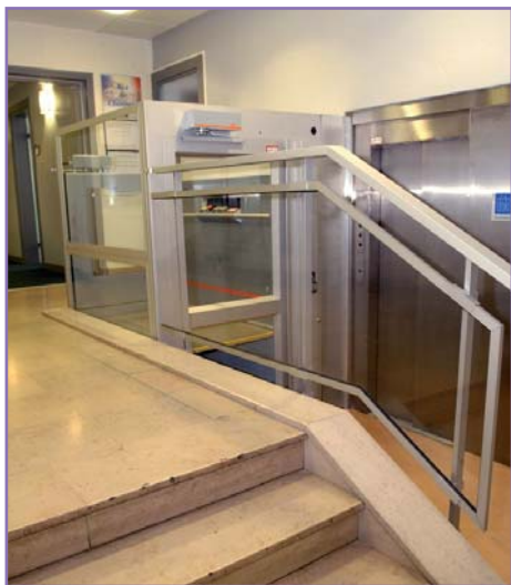
Rampe d'accessibilité pour personnes handicapées
